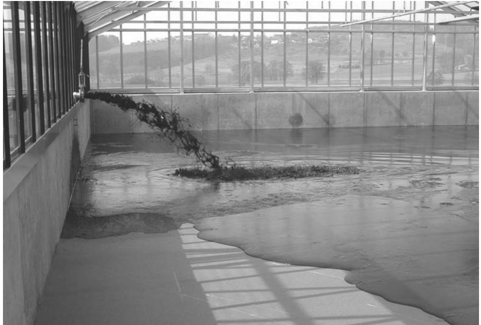
Figura 12.38. Nave-invernadero con suelo de drenaje para secado solar de fangos líquidos. Entrada de fango.
