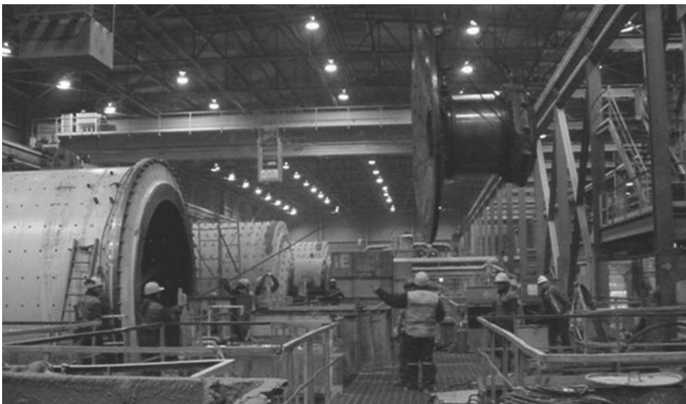
Figura 9.34. Planta de trituración secundaria, en la que se pueden observar los molinos de bolas.
