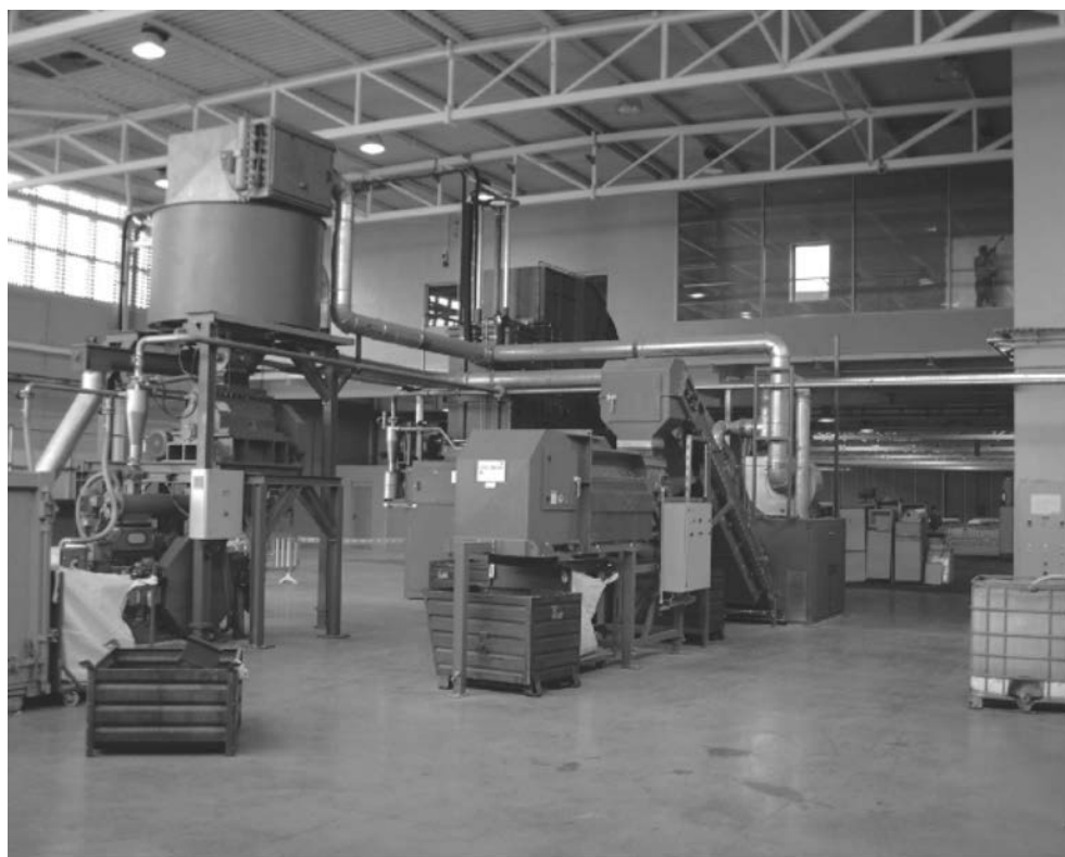
Figura 14.17. Vista general del Centro de Tratamiento y Reciclaje de Frigoríficos situada en El Pont de Vilomara i Rocafort (Barcelona). Se aprecia el separador de corrientes de Foucault y las aspiraciones que conducen el poliuretano hasta la etapa de compactación (Briquetado).
